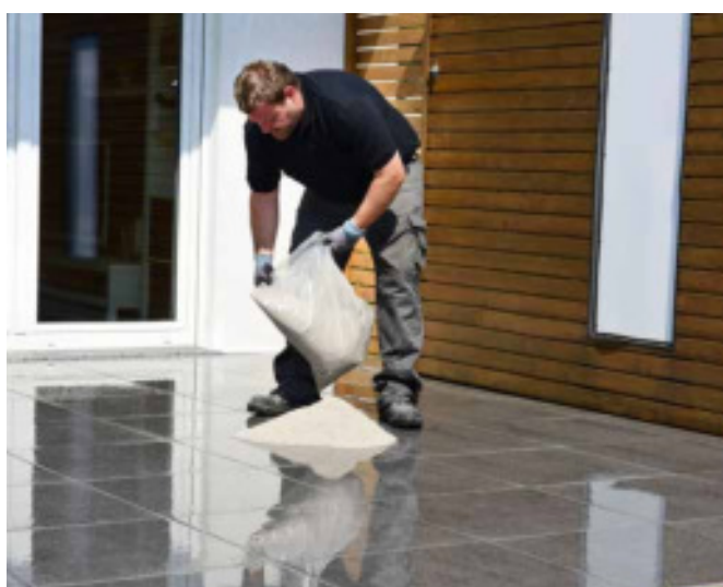
11 Pour Sopro Solitär® F20 onto covering.
